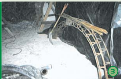
Cambota metálica treliçada, posteriormente substituída por fibras de aço
