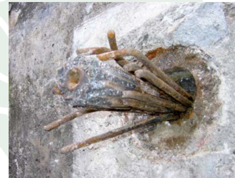
Figura 9 - Patologia - cabeças metálicas em processo de corrosão.
