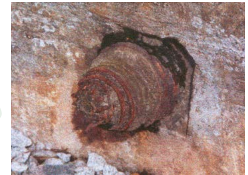
Figura 10 - Patologia - cabeças metálicas em processo de corrosão.
