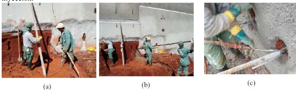
Figura 6. (a) Detalle de la ejecución de la vaina, (b) inserción del perno de anclaje en el suelo macizo posterior a la ejecución de la vaina y (c) fijación del equipamiento de inyección.
