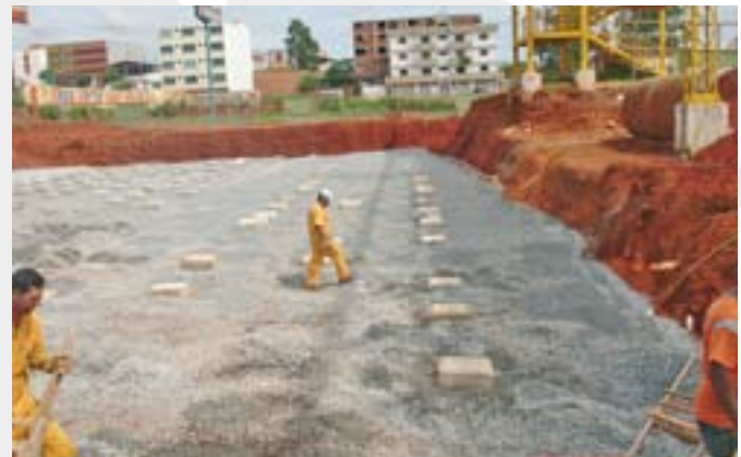
Figura 11 - Lançamento da camada de brita entre as estacas, já com os capitéis
