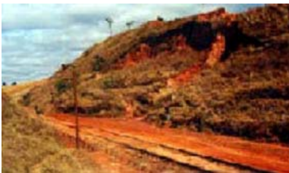
Foto 13 Vista do talude rompido,Suzano Suzano
