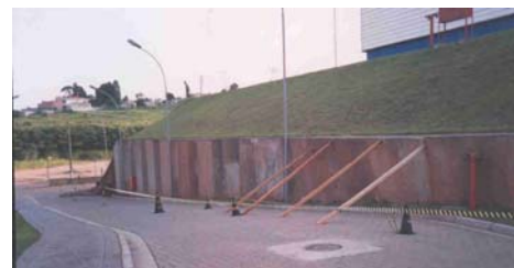
Foto 1 - Detalhe do paramento rompido. Av. JK-Guarulhos/SP
