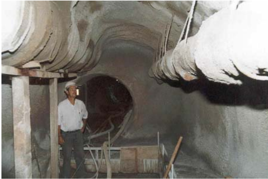
Foto 11 Detalhe de interferência junto ao “túnel/PV”
