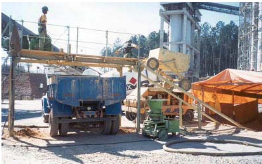
Foto 23 - Detalhe da descarga do solo escavado diretamente no caminhão para o túnel inclinado de 29°
