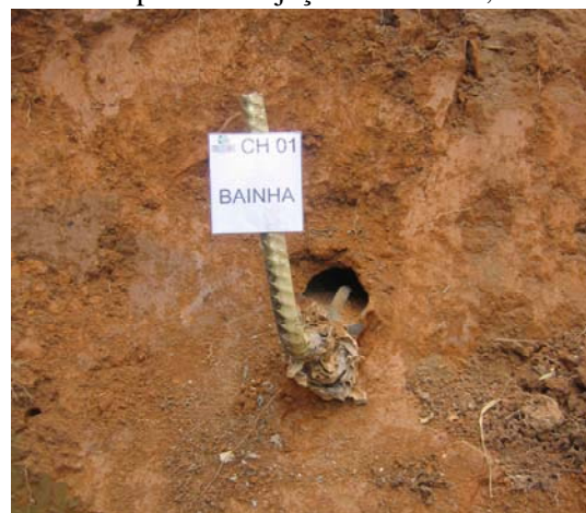
Foto 11 – Chumbador 1 injetado só com bainha
