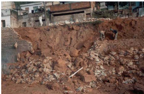
Foto 1 – Queda de Talude – Taboão da Serra - SP
