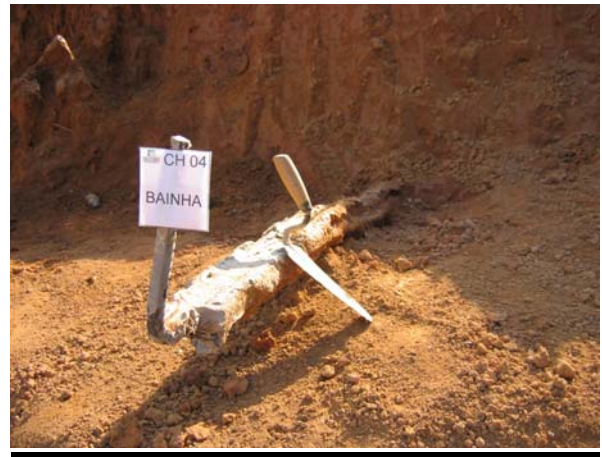
Foto 14– Chumbador 04 parcialmente escavado 3.2– Grampos com injeção de bainha e uma só fase de injeção com calda colorida;
