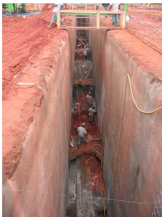
FIG.16 -Detalhe da vala, da ponte rolante. e pórtico. Execução do chumbador, escavação parcializada.
