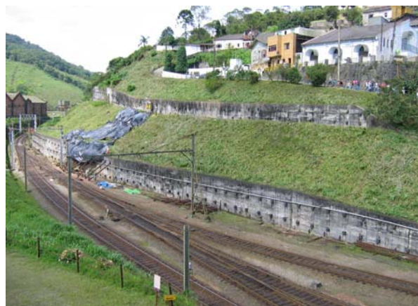
Foto 3 – Acidente ocorrido em janeiro de 2005 (Vista geral)
