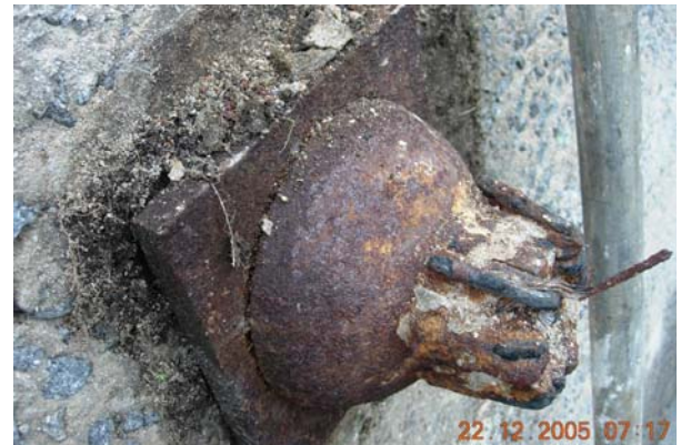
Foto 16 - Vista geral da cabeça e fios corroídos
