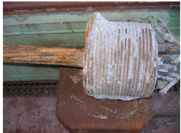
Foto 8 – Detalhe da corrosão acentuada da cabeça e dos fios.
