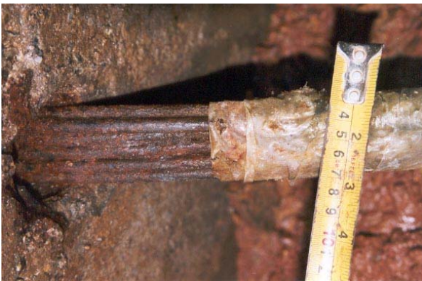
Foto 6 – Detalhe de tirante com corrosão acentuada e alguns fios rompidos. Note-se a proteção executada.
