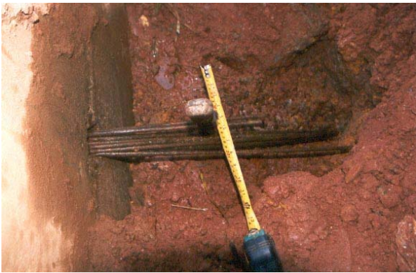
Foto 5 – Tirante escavado com corrosão acentuada e alguns fios rompidos.
