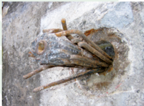
Figura 9 - Patologia - cabeças metálicas em processo decorrosão.
