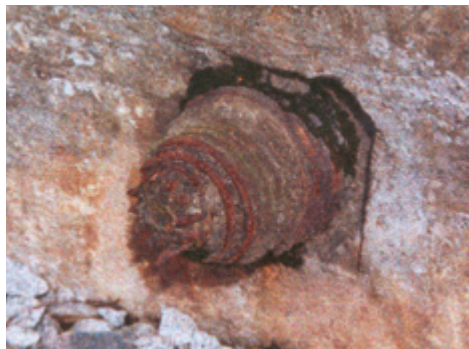
Figura 10 - Patologia - cabeças metálicas em processo decorrosão.
