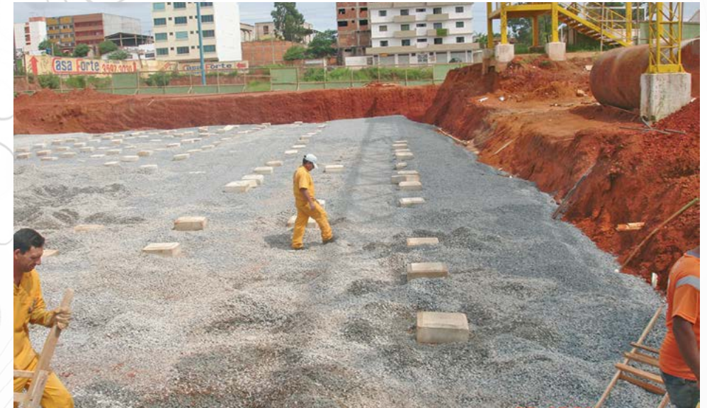
Figura 11- Lançamento da camada de brita entre as estacas, já com os capitéis.
