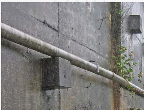
Figura 11 - Fluxo de solo em juntas e deslocamento de estrutura.
