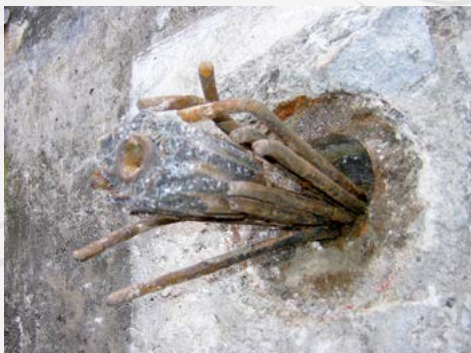
Figura 9 - Patologia - cabeças metálicas em processo de corrosão.
