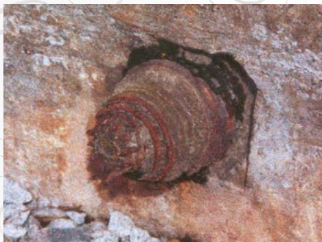
Figura 10 - Patologia - cabeças metálicas em processo de corrosão.
